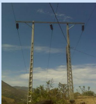
Fotografía 1.- SUBTRANSMISIÓN MACARÁ-EL EMPALME
